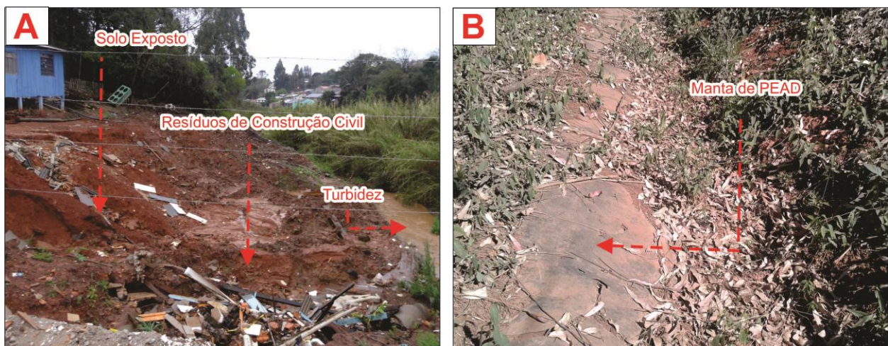
Figura 29: Exposição do solo as margens do córrego (A) e manta de proteção do solo no Aterro Municipal (B).
