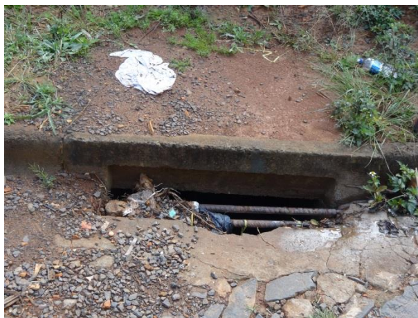
Figura 133: Boca de lobo com resíduos no entorno – Bairro Vila Ozório.
