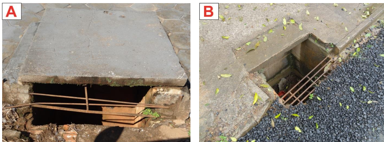
Figura 93: Caixas de inspeção danificadas -Monte Alegre (A) e Macopa (B).
