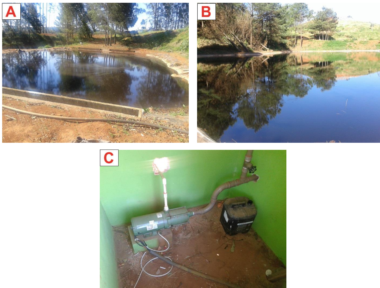
Figura 137: Lagoas anaeróbia (A) e facultativa (B) de tratamento de chorume e bomba de recirculação (C) do aterro sanitário.
