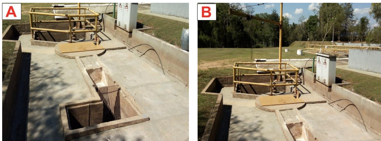
Figura 80: ETE Uvanaral, gradeamento (A); vista geral (B).
