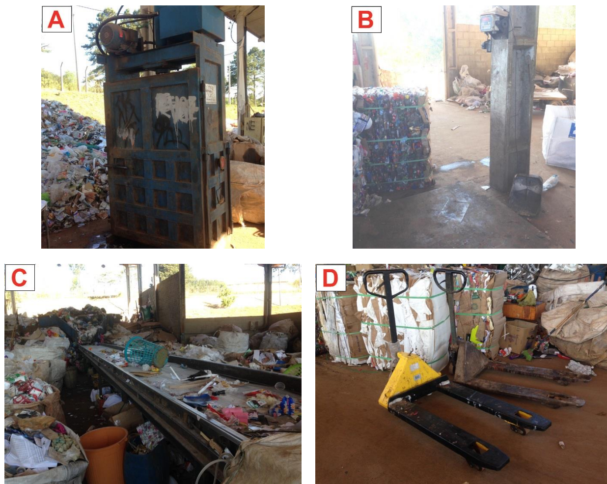
Figura 146: Equipamentos da Cooperativa Ambiental de Telêmaco Borba – Prensa hidráulica (A), balança (B), esteira (C) e carrinho para carregar material (D).
