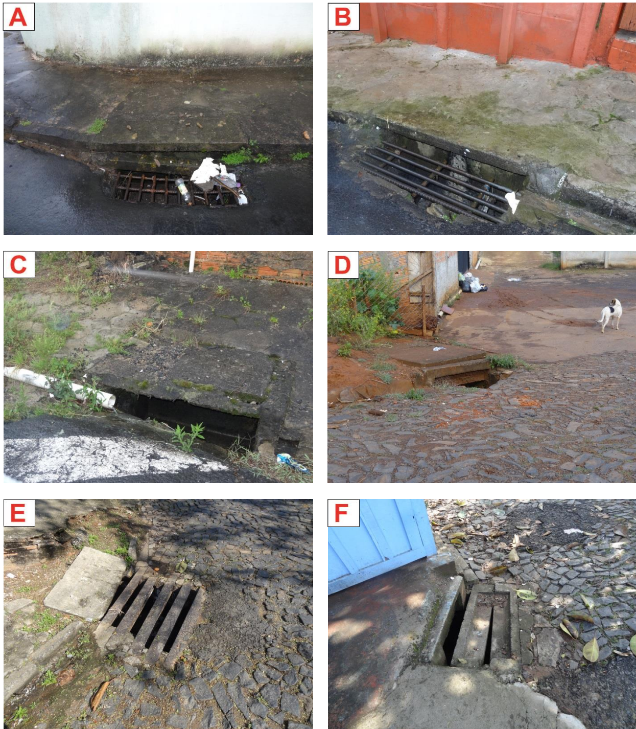
Figura 92: Tipos de boca de lobo encontradas em Telêmaco Borba - Boca de lobo com grades metálicas (A) e (B); boca de lobo sem nenhum tipo de contenção (C) e (D); boca de lobo com barras de ferro (E); boca de lobo em concreto (F).
