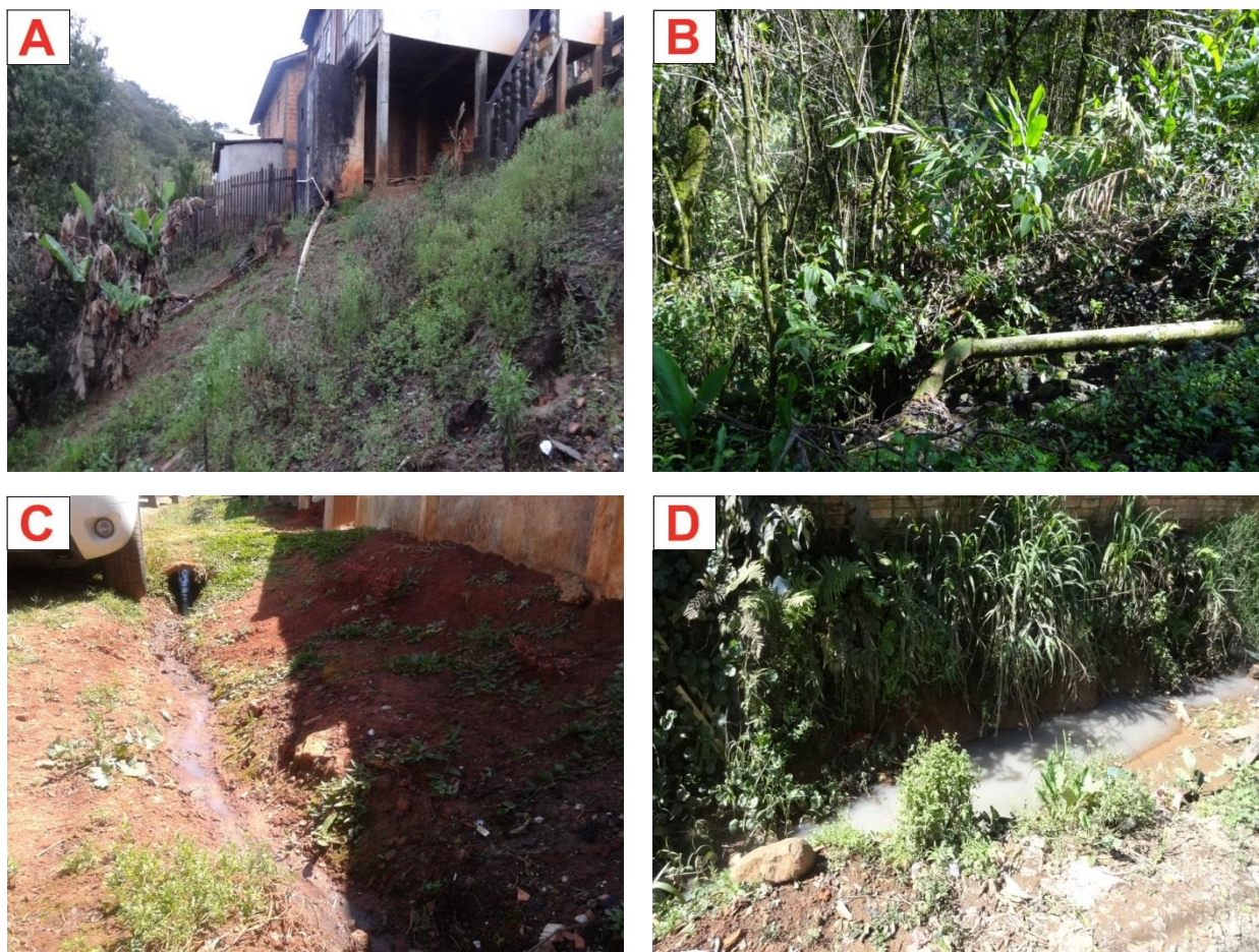
Figura 96: Possíveis ligações irregulares na rede de drenagem nos bairros Santa Rita (A) e (B), São João (C) e (D).
