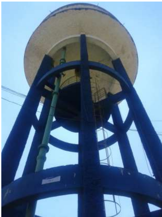
Figura 56: Reservatório Elevado (REL-02) – Alto das Oliveiras
