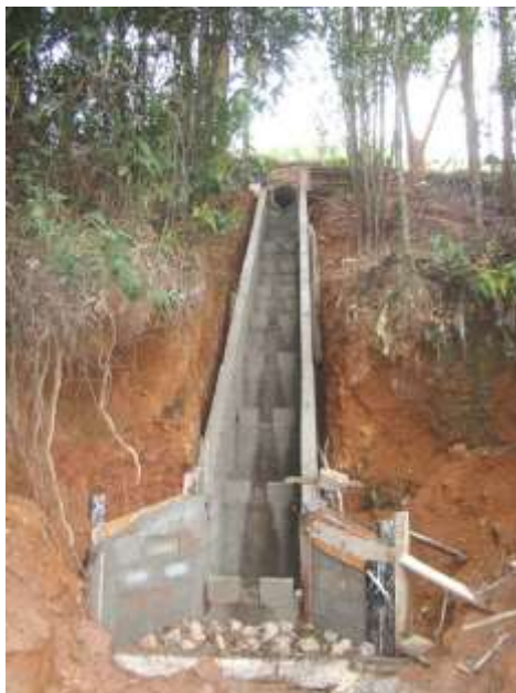
Figura 163: Dissipador de energia em degraus
